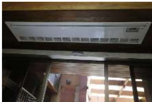
شکل ۷ نصب پرده هوا ورودی کتابخانه مرکزی
